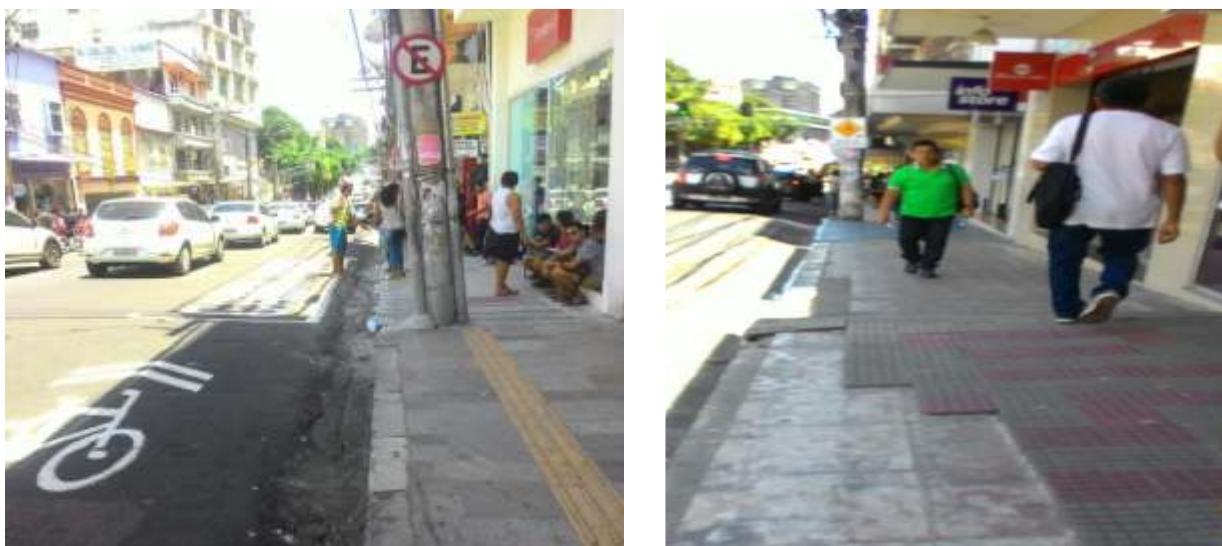
Figura 01: Observa-se a descontinuidade da guia tátil. Observa-se a possibilidade de queda devido à má conservação do ambiente. Fonte: Acervo Próprio.
