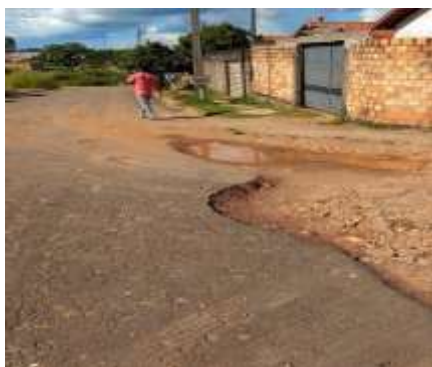
Figura 1 – Pavimentação comprometida. Créditos: PEREIRA, 2019.
